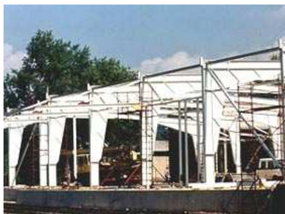
Csarnok acél tartószerkezet
