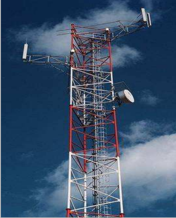
T-com átjátszó Celldömök
